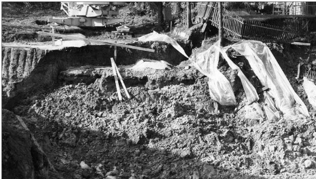
Rutschung einer Baugrubenböschung innerhalb einer fossilen Rutschung.
