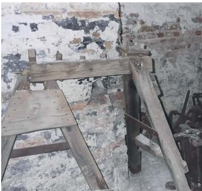
Ständig aufsteigende Feuchtigkeit hält die Kellerwand kühl, so dass ein deutlich erhöhter Energieaufwand erforderlich ist, um den Raum einigermaßen zu erwärmen. Dennoch entsteht an den Außenwänden Kondenswasser, das die Ziegelwand durchfeuchtet.
