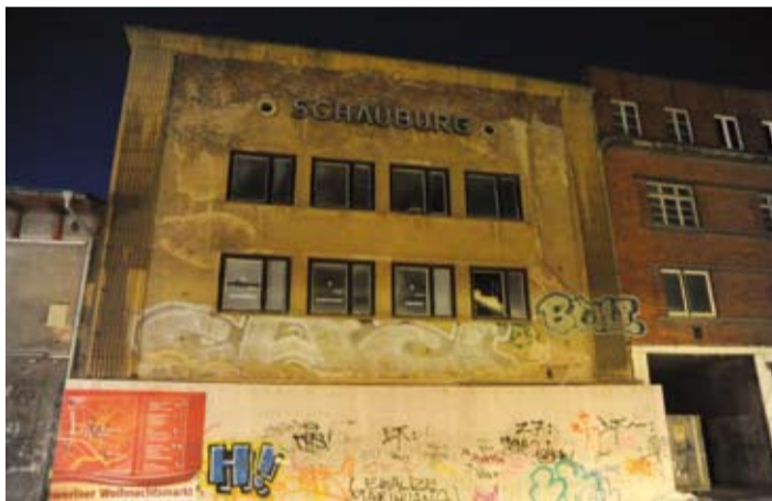
Welch unsägliches Bild illegale Graffiti - gekoppelt mit dem Zerfall ungenutzter Gebäude - den Menschen der Stadt sowie unseren Gästen bietet, zeigt besonders deutlich die Fassade des ehemaligen Filmtheaters „Schauburg“
