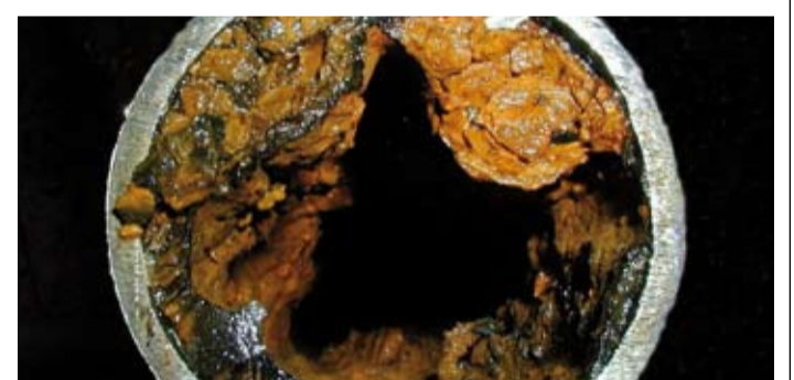
Erkennbar zugesezte Rohrwinnenwand vermindert Durchflussleistung und führt letztlich zum „Rohrfarkt“
