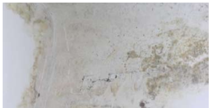
Ist einmal Schimmel in den Wänden, ist eine ursachenbedingte, komplexe Sanierung des Bereiches der einzig richtige Lösungsansatz
